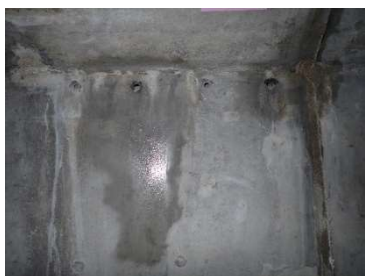
① 漏水状況
